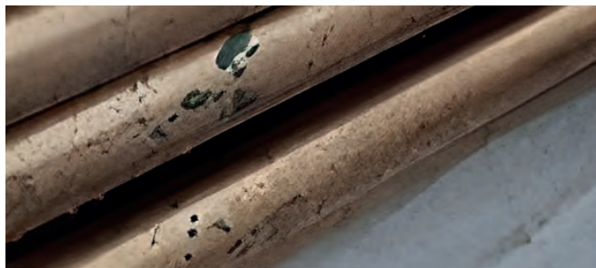
Figura 26 - Esempio di vaiolature su tubi in cupronichel
